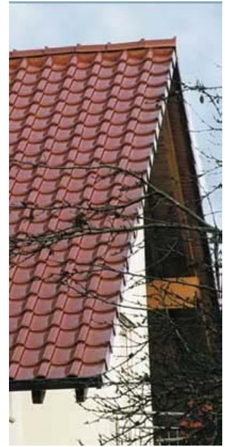
Takstein. Bildene over og under er fra Skarpnes hjemmesider .
